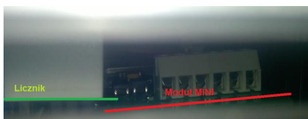
Rys.4 Problem przekrzywienia modułu po zamknięciu licznika
